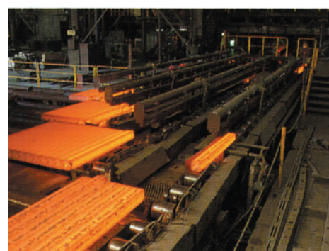
連続鑄造設備
